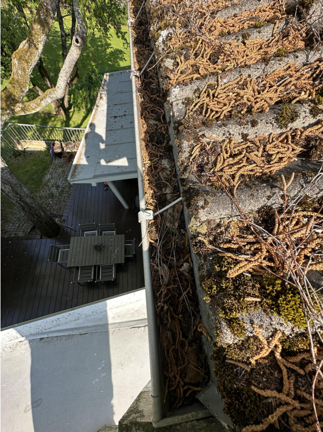
Mye nedfall på tak og i takrenner på tilbygget.
