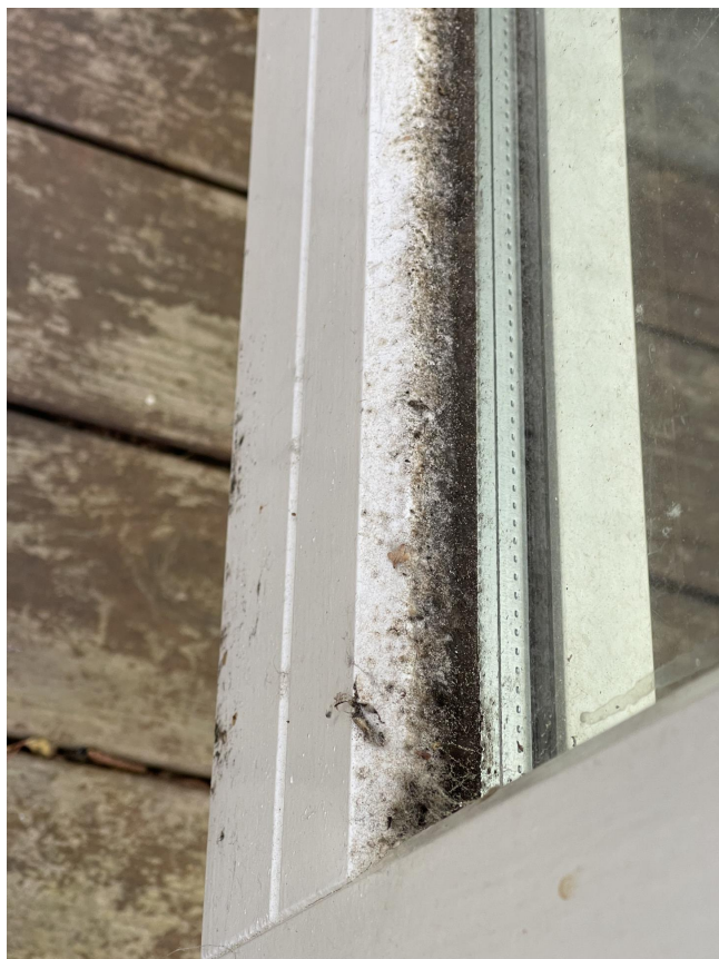
Svartsopp på innsiden av vinduskarm i hybel som følge av live ventilasjon og kondens.
