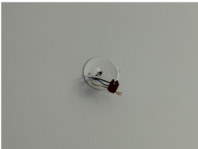
Åpne kabler i kjellerstue.
