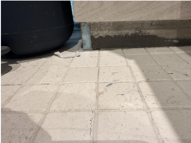
Synlig membranplate i vegg uten vanntett skjøt.
