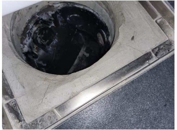
Kommentar - [Sluk vaskerom ]
