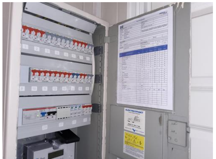
Beskrivelse - [Sikringskap og kursfortegnelse ]
