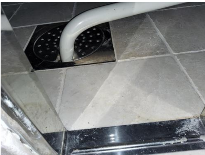
Membran, tettesjikt og overgang til sluk. - [Sluk under badekar 2.etasje ]
