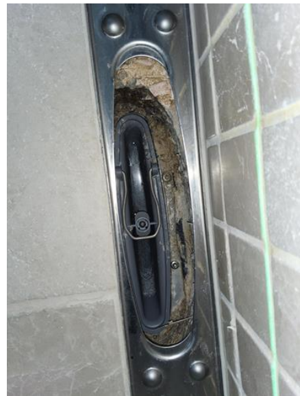
Fallforhold (gulv) - [Sluk i dusj 2.etasje ]
