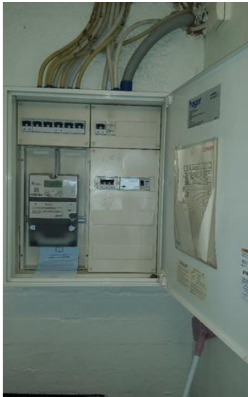
Elektrisk anlegg - [Sikringsskap utleiedel ]
