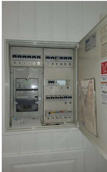
Elektrisk anlegg - [Sikringskap hoveddel ]
