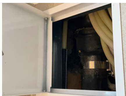
Enkelte vannledninger er ikke koblet til rør i rør systemet
