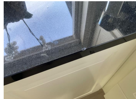
Det har gått enkelte skall av benkeplate
