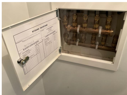
Koblingskap for badet i 2.etg.
