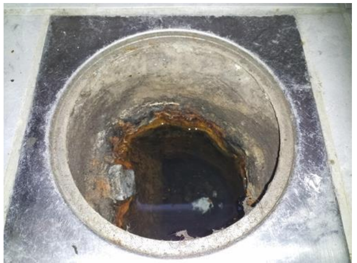
Kommentar - [Sluk i bad. 1.etasje.]
