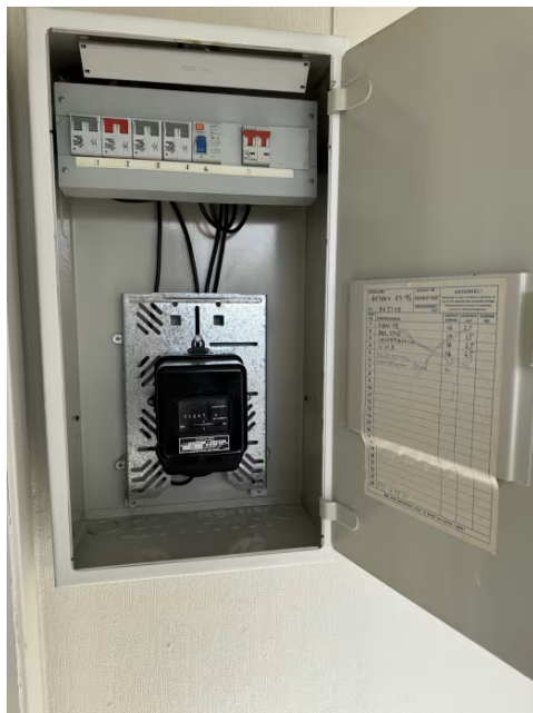
Sikringskap i hybel.
