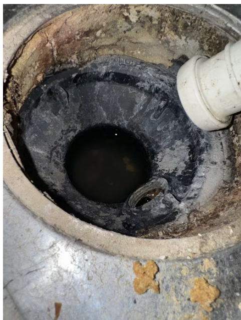
Sluk på vaskerom.
