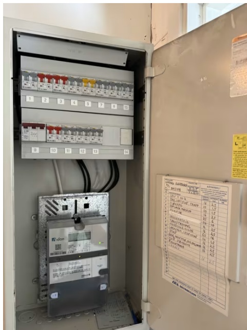
Sikringskap i hoveddel.
