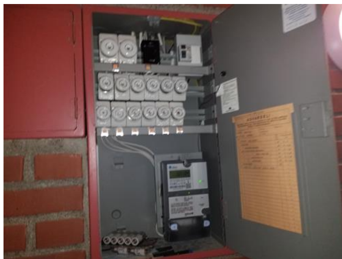
Elektrisk anlegg - [Sikringsskap. ]
