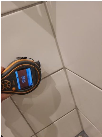
Fukt i tilliggende konstruksjoner - [Fuktsøk dusjsone]
