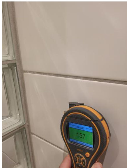
Fukt i tilliggende konstruksjoner - [Referanse fuktsøk]
