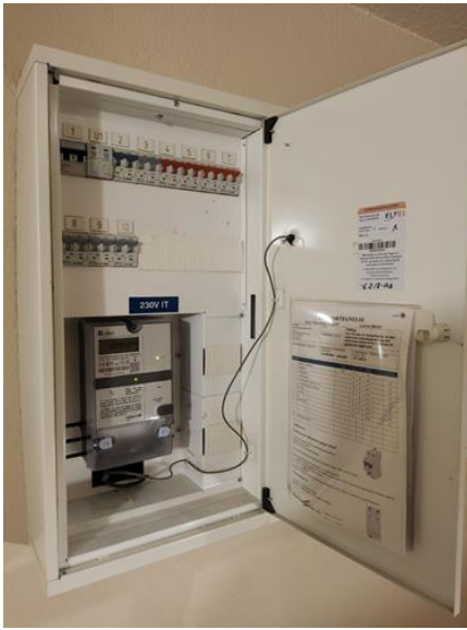
Elektrisk anlegg - [Sikringskap ]
