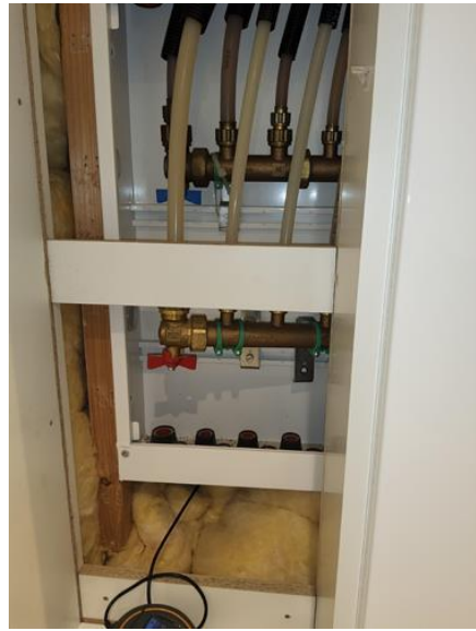
Vannrør - [Fordelerskap med åpninger i veggkonstruksjon.]
