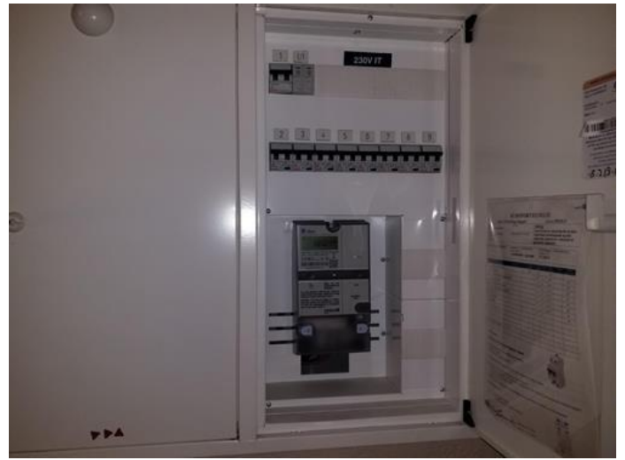
Elektrisk anlegg - [Sikringskap. ]
