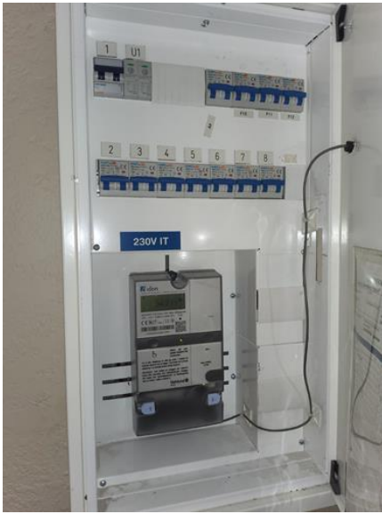
Elektrisk anlegg - [Sikringskap ]
