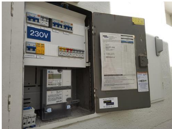
Beskrivelse - [Sikringsskap og kursfortegnelse ]
