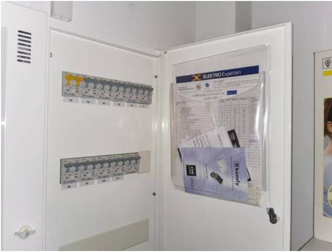
Beskrivelse - [Sikringskap med kursfortegnelse.]
