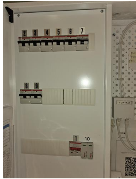
Elektrisk anlegg - [Sikringskap ]
