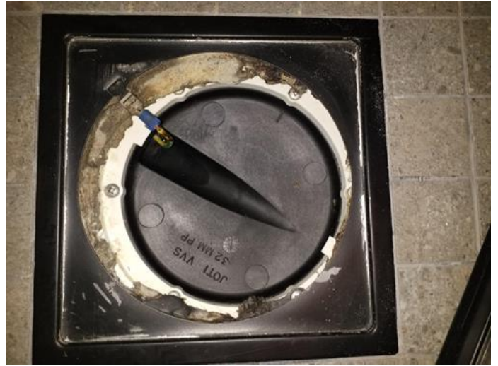
Membran, tettesjikt og overgang til sluk. - [Hjelpesluk i dusjsone.]
