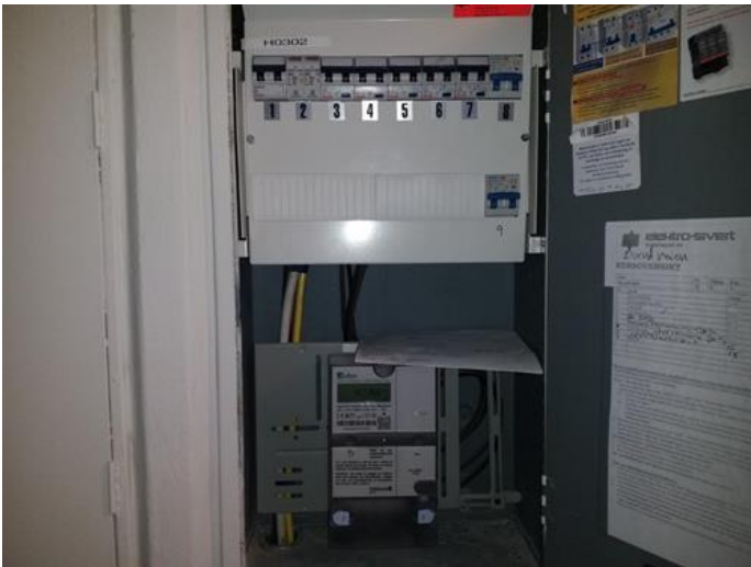
Elektrisk anlegg - [Sikringskap.]
