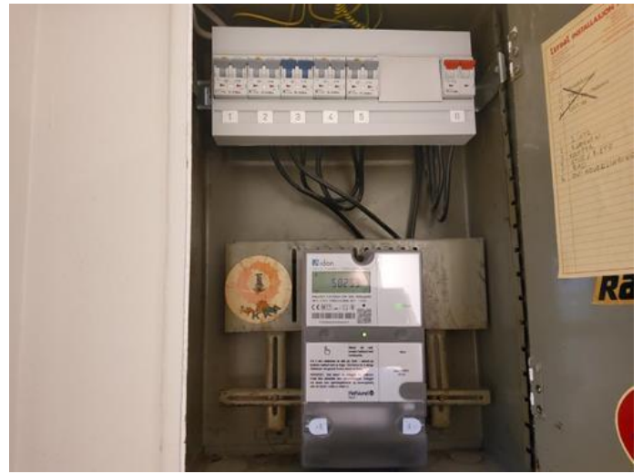
Elektrisk anlegg - [Sikringskap]
