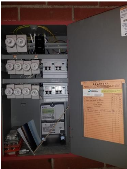
Elektrisk anlegg - [Sikringskap ]
