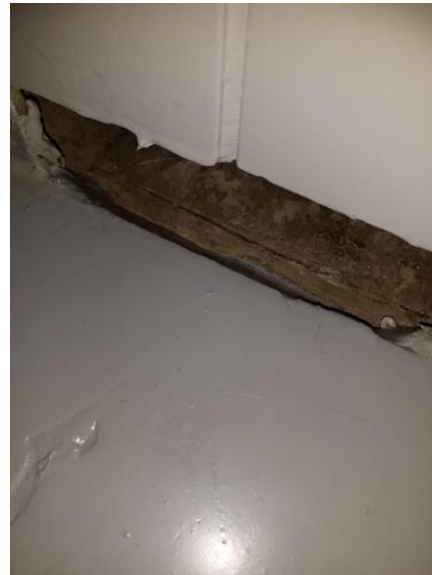
Membran, tettesjikt og overgang til sluk. - [Sprekk gulvbelegg ]
