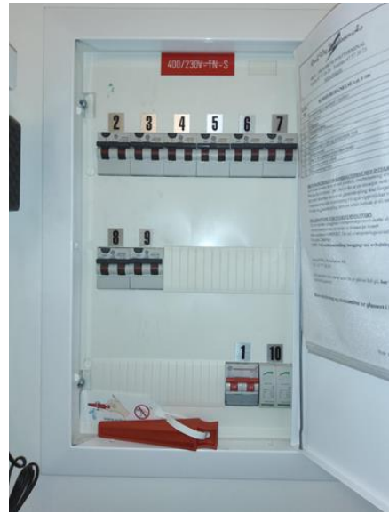
Elektrisk anlegg - [Sikringskap]
