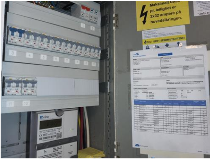
Beskrivelse - [Sikringskap med kursfortegnelse.]
