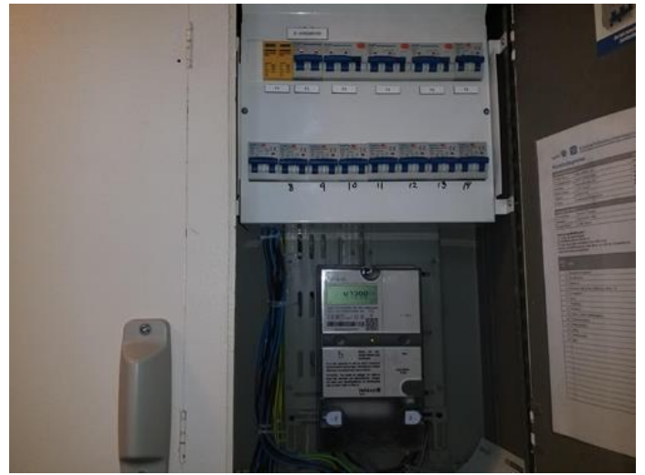
Elektrisk anlegg - [Sikringskap.]
