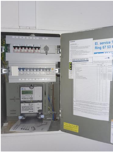
Elektrisk anlegg - [Sikringskap ]
