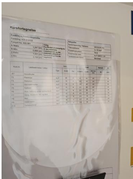
Elektrisk anlegg - [Kursfortegnelse]
