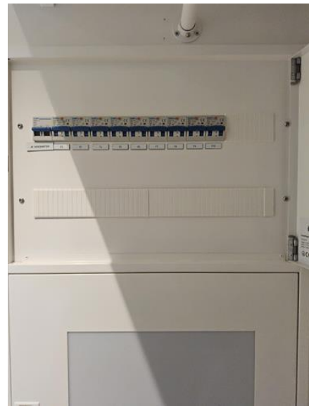
Elektrisk anlegg - [Sikringskap]
