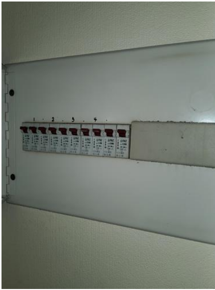
Elektrisk anlegg - [Sikringskap ]
