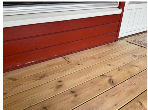
Mangler beslag i overgang veranda og yttervegg.
