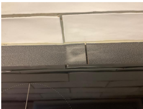
Svelling i skjøt av benkeplaten.
