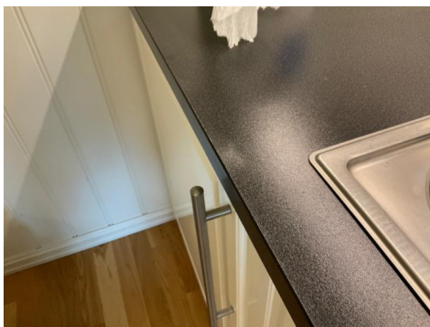
Svelling i front av benkeplate.
