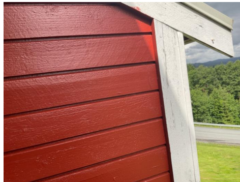
Avflassing av maling.
