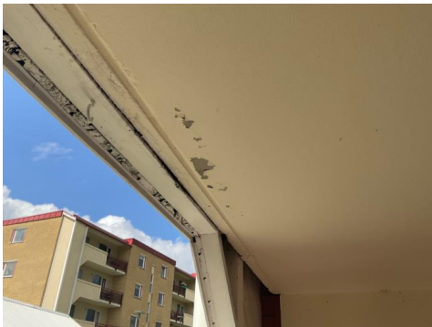
Avflassing av maling i himling.
