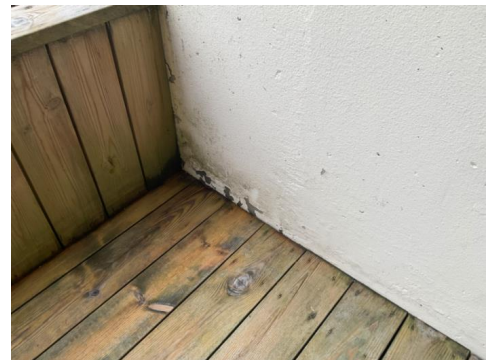
Avflassing av maling på levegg.
