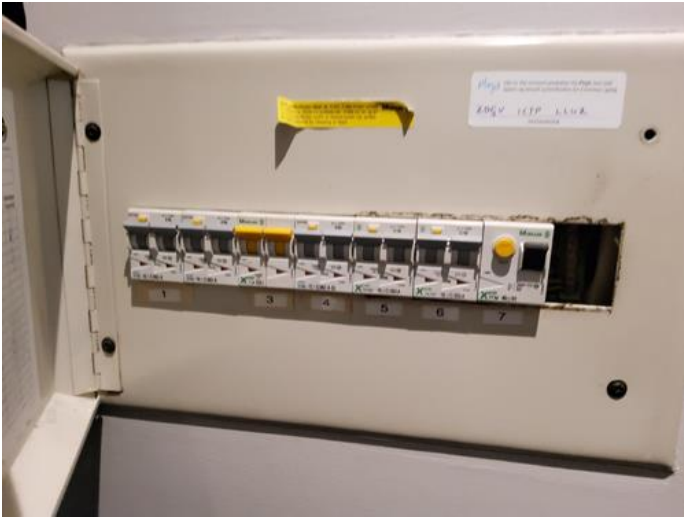
Elektrisk anlegg - [Sikringskap]
