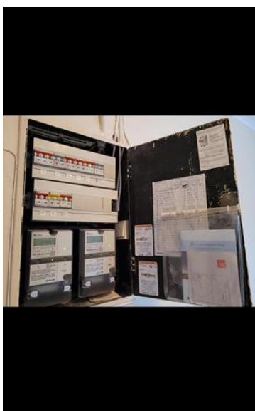
Elektrisk anlegg - [Sikringsskap]
