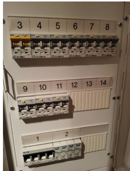
Elektrisk anlegg - [Sikringskap ]
