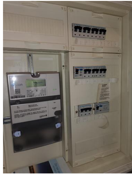
Elektrisk anlegg - [Sikringsskap]
