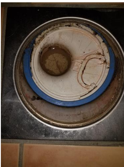
Membran, tettesjikt og overgang til sluk. - [Sluk bad med adkomst via soverom ]
