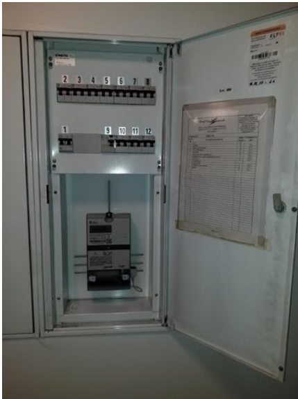
Elektrisk anlegg - [Sikringskap ]
