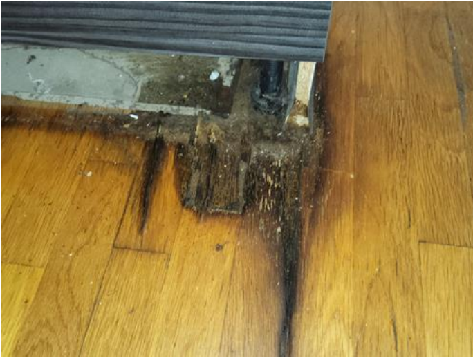
Kommentar - [Skade gulv kjøkken. ]
