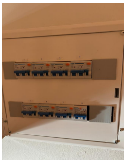
Sikringskap plassert i entre/gang.
