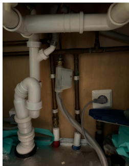
Avløpsrør i underskap vask på kjøkkenet.
