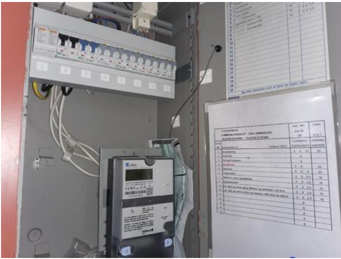
Beskrivelse - [Sikringskap med kursfortegnelse.]
