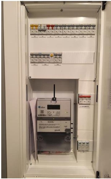
Elektrisk anlegg - [Sikringskap ]
