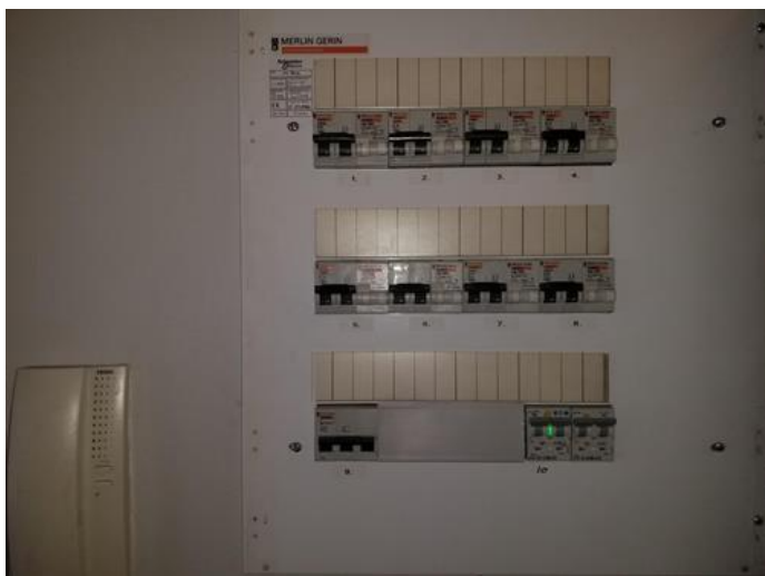
Elektrisk anlegg - [Sikringsskap.]
