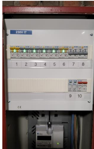
Elektrisk anlegg - [Sikringskap ]
