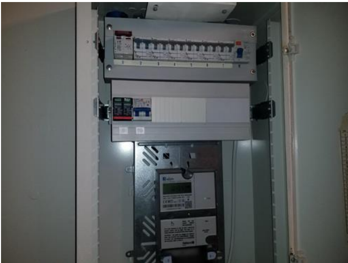
Elektrisk anlegg - [Sikkeringskap. ]
