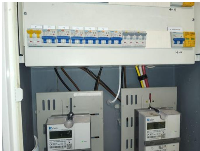
Elektrisk anlegg - [IMG_20240522_135648]
