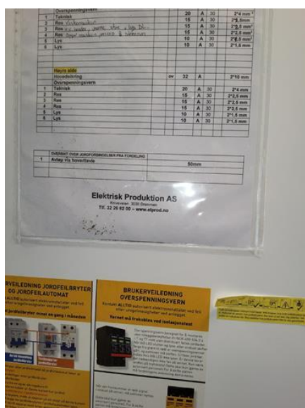
Elektrisk anlegg - [IMG_20240522_135706]
