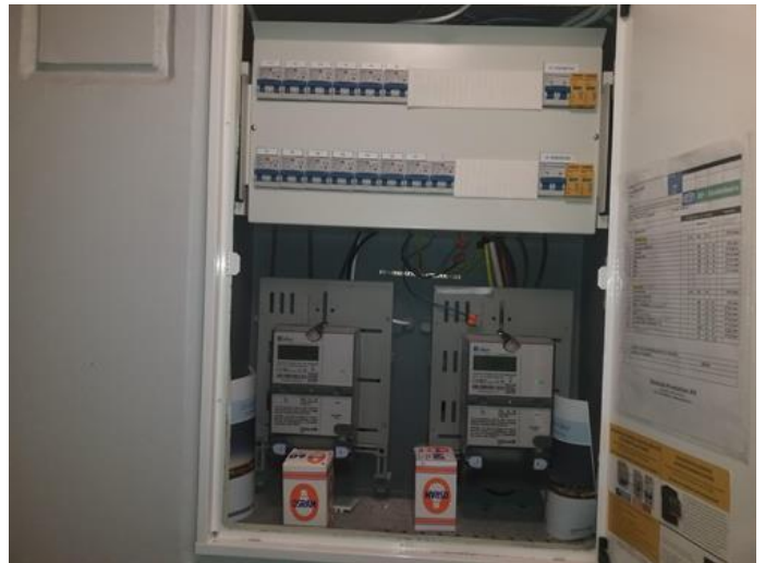
Elektrisk anlegg - [Sikringsskap. ]
