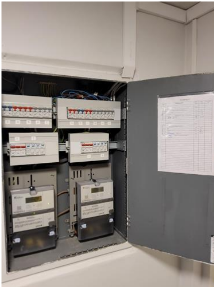
Elektrisk anlegg - [Sikringsskap (Venstre)]
