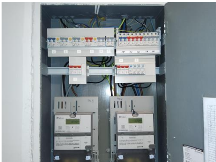
Elektrisk anlegg - [Sikringsskap ]
