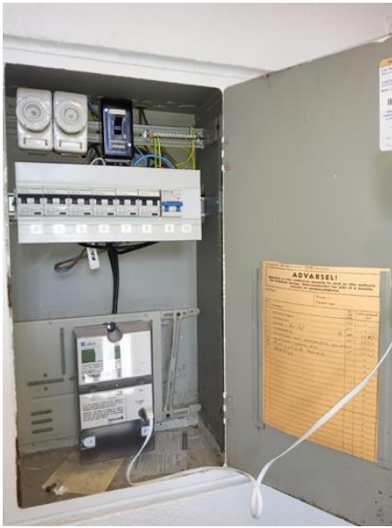
Elektrisk anlegg - [Sikringskap ]
