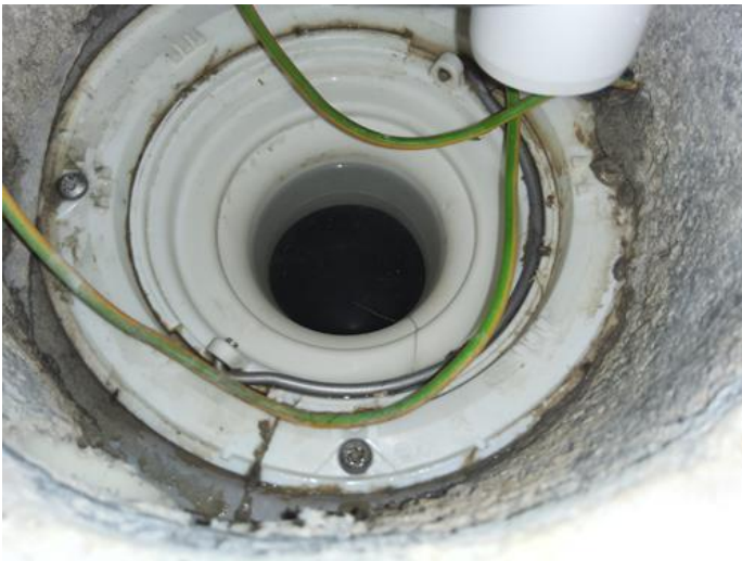
Avløpsrør (ink. sluk) - [Sluk baderom ]
