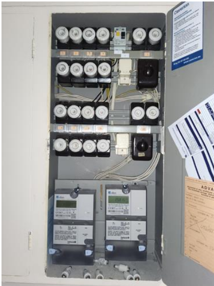
Elektrisk anlegg - [Sikringskap ]
