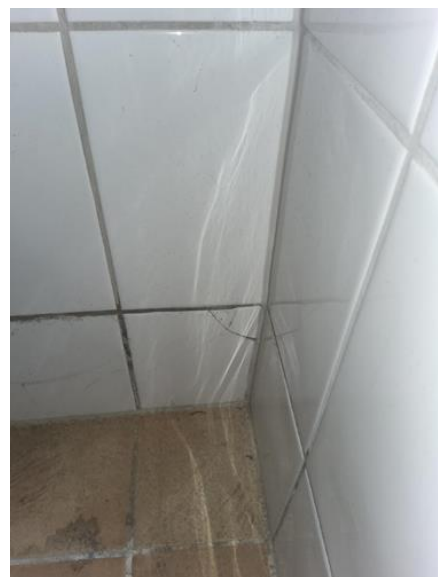
Overflater vegger - [Riss/sprekker påvist på veggflis ]
