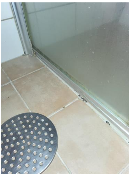
Overflater gulv - [Misfarging/svertesopp/stedvis manglende vedheft elastiske flisfuger bad]
