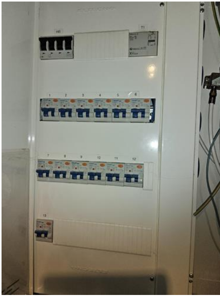
Elektrisk anlegg - [Sikringskap ]
