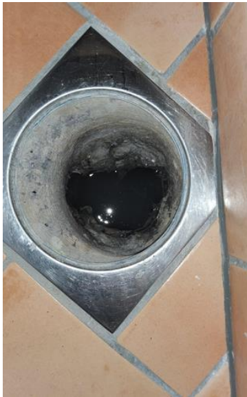
Avløpsrør (ink. sluk) - [Sluk på vaskerom ]
