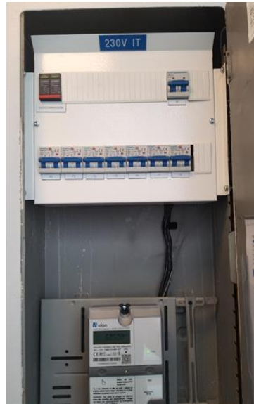
Elektrisk anlegg - [Sikringsskap ]
