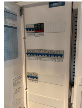
Sikringskap med automatsikringer.
