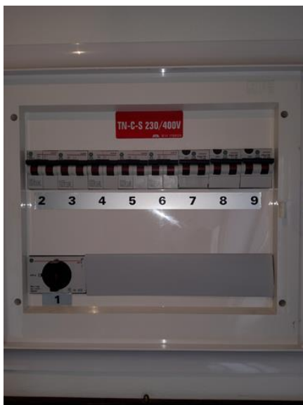
Elektrisk anlegg - [Sikringsskap]
