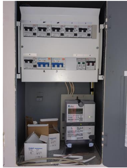
Elektrisk anlegg - [IMG_20240411_133728]
