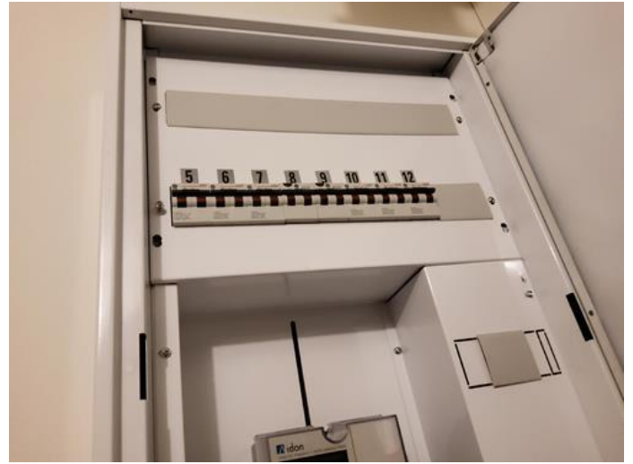
Elektrisk anlegg - [Sikringskap]
