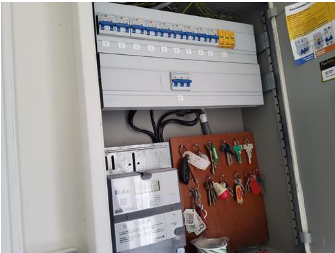
Elektrisk anlegg - [Sikringskap ]
