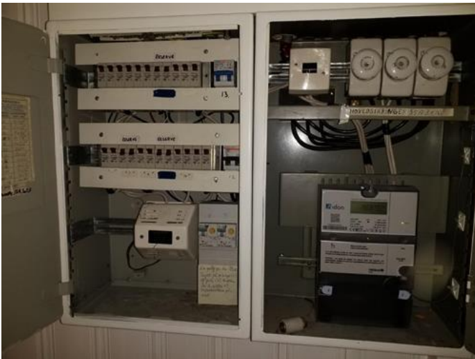
Elektrisk anlegg - [Sikringskap ]
